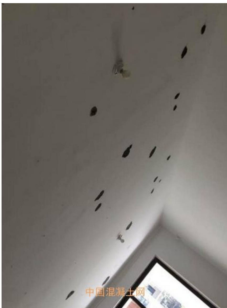
十幢楼的房顶都坑坑洼洼
