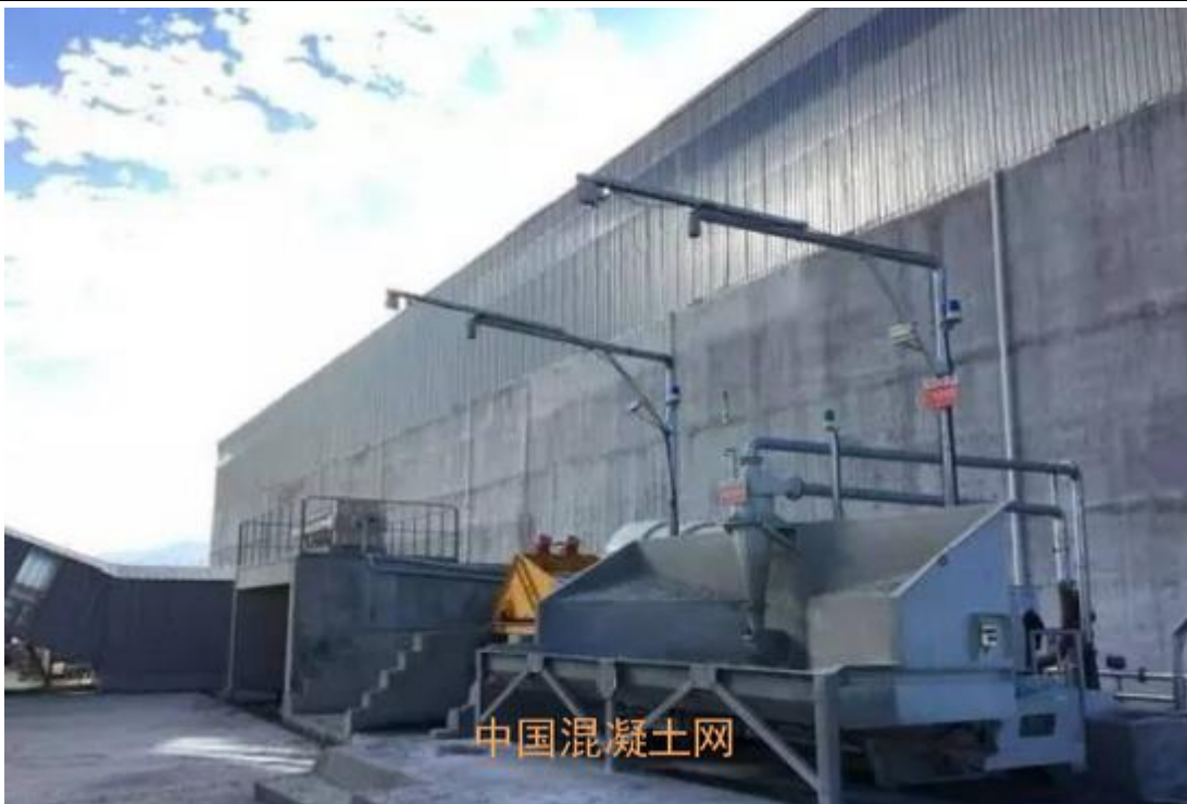
废水处理系统
